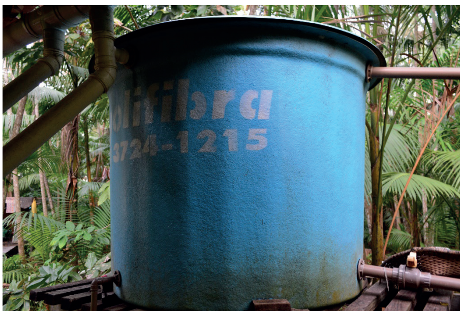
Figura 23 - Instalação de captação de água da chuva em Jutuba. Fonte: SCHIFFER, 2017
